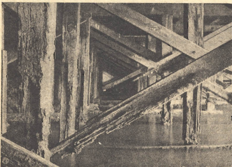
Fig. 3. — Pontile di imbarco a Hobson, costruito nel 1881. Interno della estremità, lato orientale. Si vedono i piloni, i raccordi, ecc. di legno di totara distrutti da Limnoria lignorum . A bassa marea. Differenza di 3 piedi fra il livello della bassa e quello dell'alta marea. (Fotografia di Hamer).
